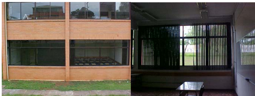
Figura 1 – Esquadrias do prédio do curso de Engenharia de Alimentos – vistas externa e interna
