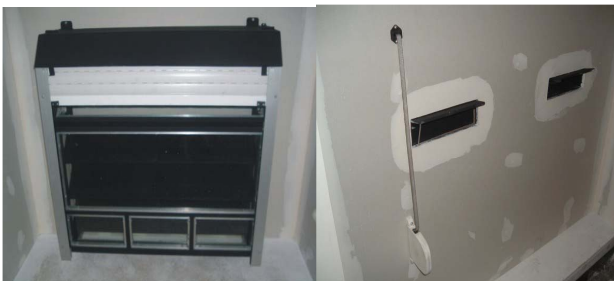
Figuras 4 e 5 – Vistas frontal e da parede interna do Termo-acumulador
