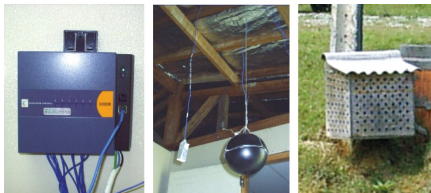
Figura 2 - Equipamento de aquisição, sensores de temperatura internos e externos.
