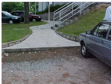
Figura 2 - Estacionamento da agência com piso inadequado, degrau, ausência de corrimão e borda lateral na rampa
