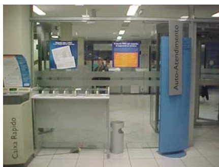
Figura 3 – Acesso alternativo para deficiente sem sinalização e bloqueado pela lixeira e móvel
