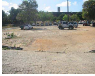
Figura 5 – Destruição do meio-fio da rotatória.
