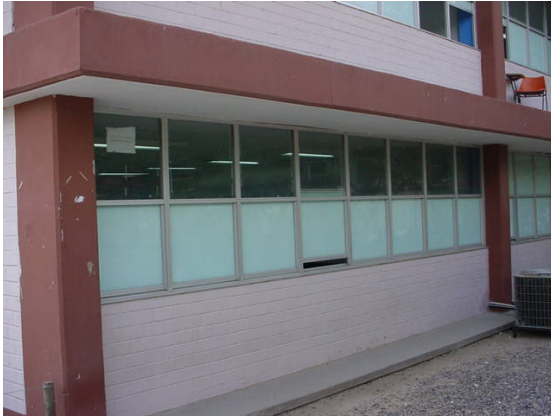
Fig. 1: Ventanas parcialmente pintadas.
