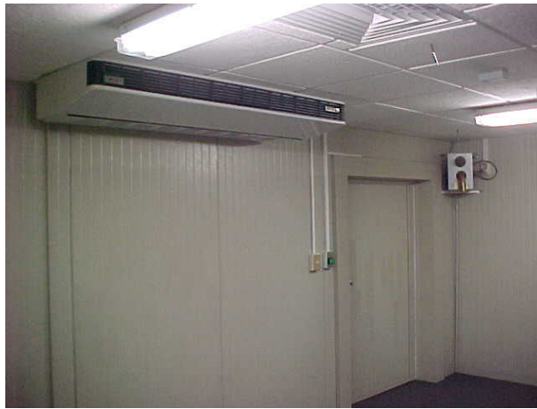
Fig. 1. Laboratorio de Ambiente controlado (LAC). Cámara Fría
