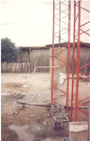
FIG. 3: Sistema de bombeo con accionamiento directo sobre el varillaje de la bomba. Altura manométrica de bombeo: 10 m. (Pozo 5 -Localidad: Sta Victoria Este)
