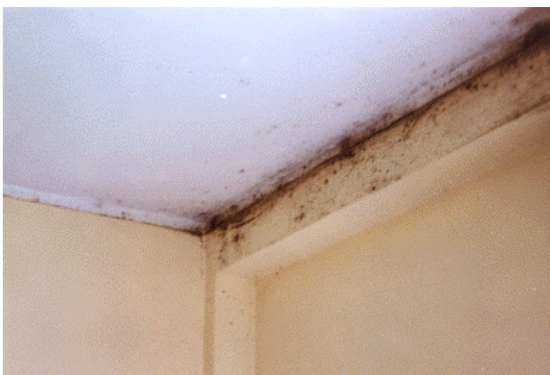
Fig. 1 Manchas localizadas numa zona de ponte térmica
