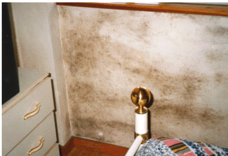
Fig. 2 Manchas generalizadas a toda a superfície de uma parede
